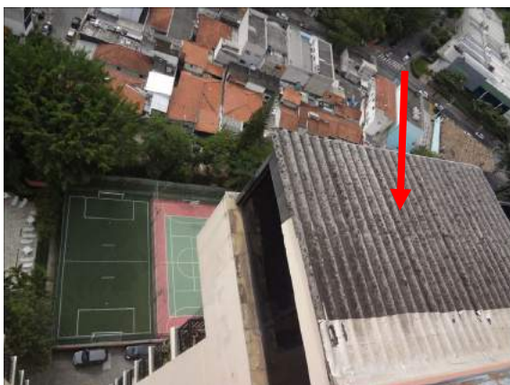
FOTO 58- Outra vista da Cobertura em telhas, da Sala ampliada do apartamento 183, penhorado.
