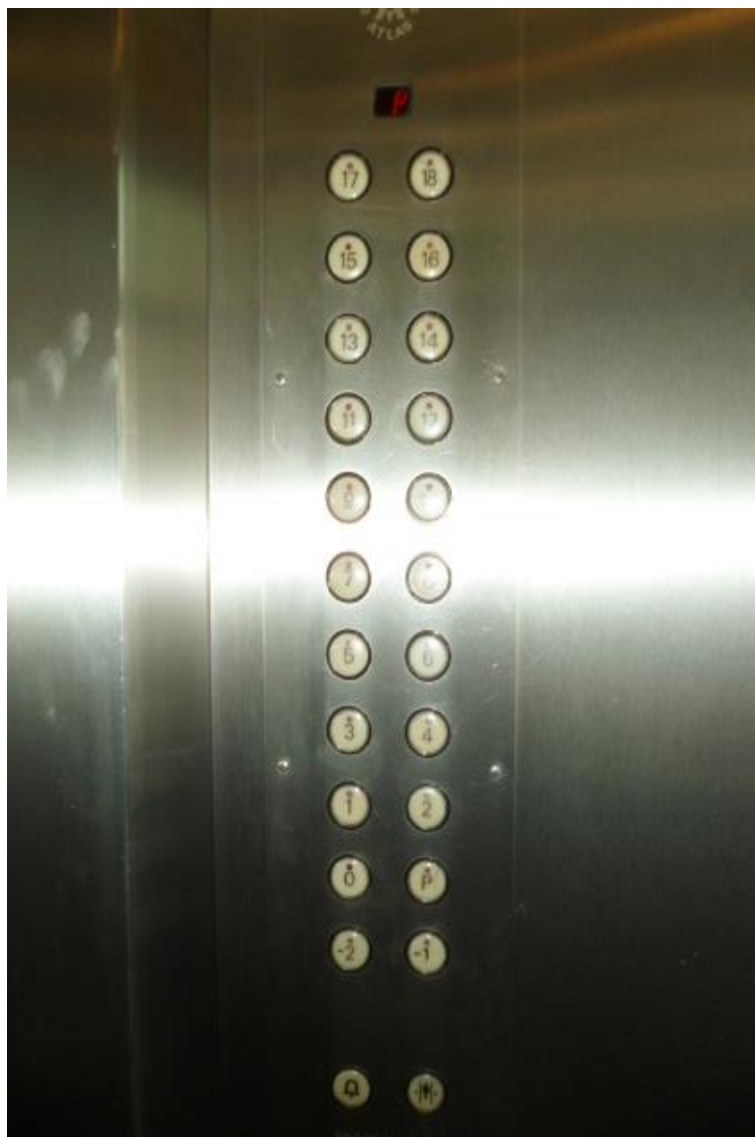
FOTO nº 05 Vista do painel de acesso aos andares.
